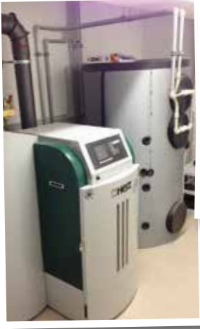
Eine effiziente Heizanlage spart Heizkosten
